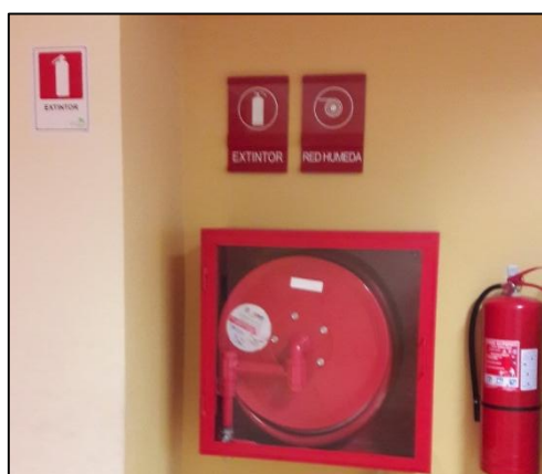
PROTECCION CONTRA INCENDIO
